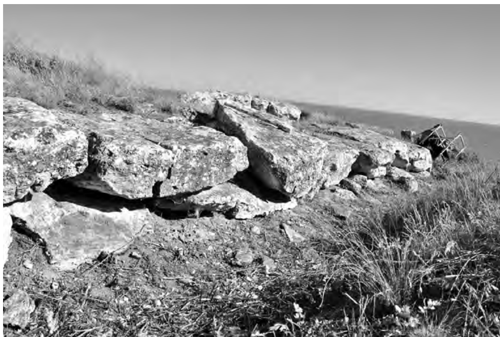
Рис. 10. Выбивание вверх, наклон к югу и разворот против часовой стрелки каменного блока 5 в южном фасае стены № 2 (на нем расположена измерительная рулетка). Соседний к западу камень 6 наклонился на восток и раскололся. Его западная отколотая часть немного просела вниз, образовав небольшие pull-apart'ы – крошечные аналоги Мертвого моря или Галилейского озера
