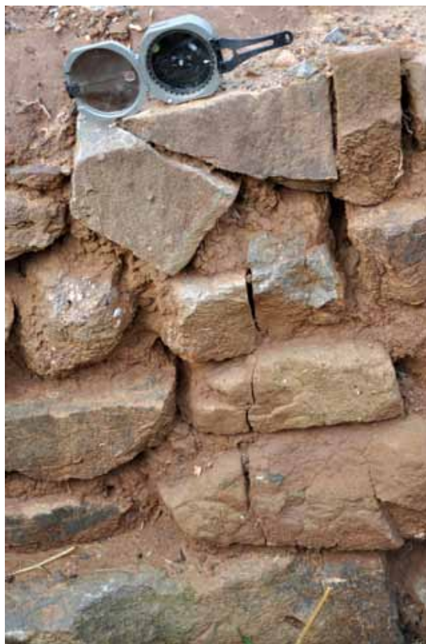
Рис. 14. Сквозная трещина, пробивающая насквозь три камня в одной из комнат к северо-востоку от сахароварни
