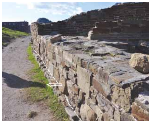
Рис. 5. Несовпадение простираний верхней части стены и ее нижнего ряда каменной кладки наблюдаются в стене восточно-северо-восточного простирания фундамента городской таможни. Верхняя часть стены выдвинулась на западо-северо-запад на 10 – 15 см. Один из камней второго ряда зацепился за нижние камни и наклонился в противоположную сторону. Фото 2015 г.
