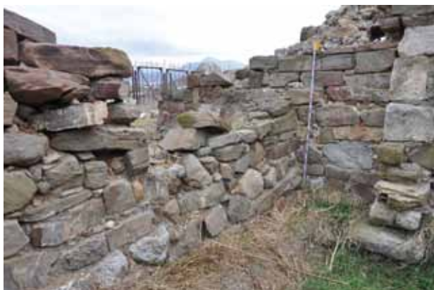
Рис. 4. Сильный наклон на север северной стены в одном из помещений к северо-востоку от Безымянной башни № 10. Имеется также небольшое (первые сантиметры) последовательное смещение рядов кладки к северу, поэтому каждый нижний ряд кладки образует небольшую площадку относительно верхнего
