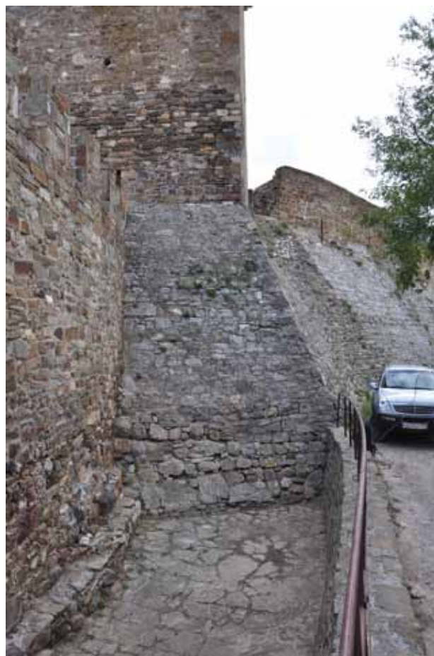
Рис. 17. Стена-контрфорс к западу от входа в крепость. Была сооружена, по-видимому, для предотвращения дальнейшего наклона и обрушения на север северной стены Судакской крепости. Фото 2015 г.
