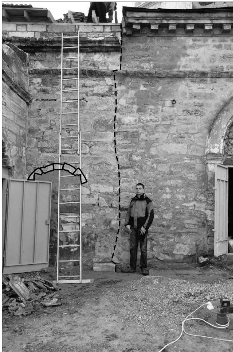
Рис. 6. Граница раздела между восточной – старой частью церкви монастыря Св. Георгия (слева от штриховой линии), построенной в XIV веке, и средней частью (справа от штриховой линии), построенной в XIX веке в северной стене церкви. Храм несколько раз перестраивался, о чем свидетельствует заложенный вход в старой части здания. Дверь справа – современный вход в церковь, дверь слева – вход в северо-восточную пристройку. Вид на юг.
