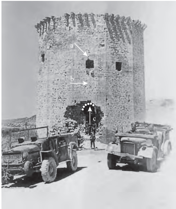
Рис. 6. Чоргунская башня, грань с простираением 30^\circ : a – трещина в плите перекрытия окна; b – межблоковая трещина; c – остатки арки на входе в башню. Фото 1943 г.
