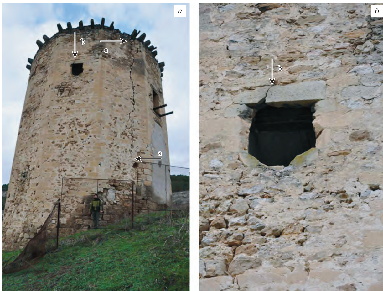
Рис. 10. Чоргунская башня, общий вид граней с простиранием 30^\circ , 60^\circ , 90^\circ и 120^\circ (а) и фрагмент грани с простиранием 90^\circ (б): а – межблоковая трещина с расширением кверху в грани с простиранием 60^\circ ; б – трещина в плите перекрытия в грани с простиранием 90^\circ
