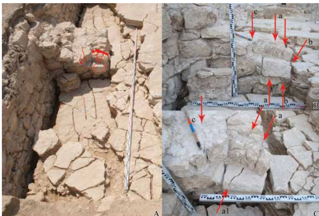
Рис. 12. Форт Меншиков. Контрфорс-пилон 5 (строчными буквами указаны трещины, пробивающие два блока подряд).
