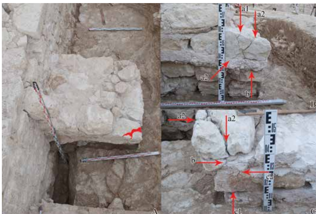
Рис. 13. Форт Меншиков. Контрфорс-пилон 6 (строчными буквами указаны трещины, пробивающие два-три блока подряд).
