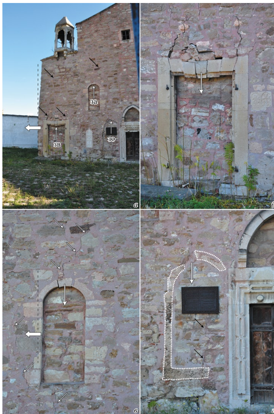
Рис. 4. Деформации в западной стене храма Архангелов Гавриила и Михаила. Фотография 2015 г.
