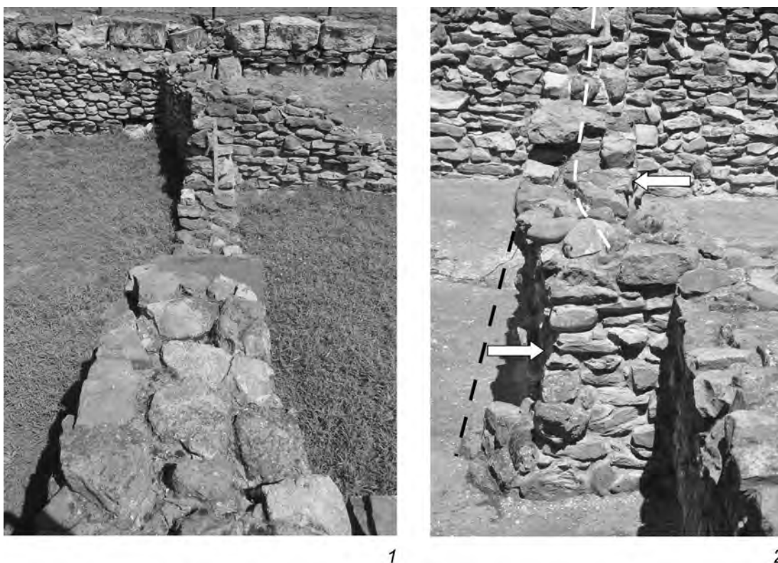
Рис. 6. 1 – т. н. 11–19: субмеридиональная дугообразная деформация восточной стены помещения 99 дома 18 IV строительного периода (вид с юга); 2 – т. н. 9–19: S-образная деформация восточной стены помещения 56 дома 6 IV строительного периода (вид с юга), как в плане (показана белой штриховой линией), так и в разрезе (показана белыми стрелками и черной штриховой линией)
