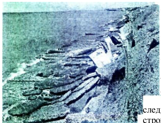
Рис.3. Фрагменты разрушенной штормовыми волнами набережной (опоры, пролеты, лестничные марши) между пос.Верстовое и Песчаное.
